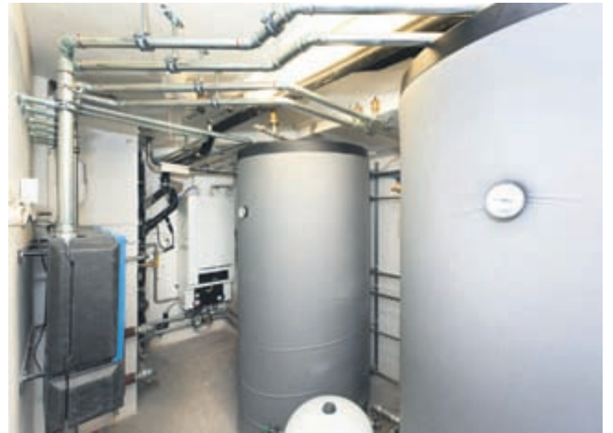
Heizanlage für drei Häuser.
