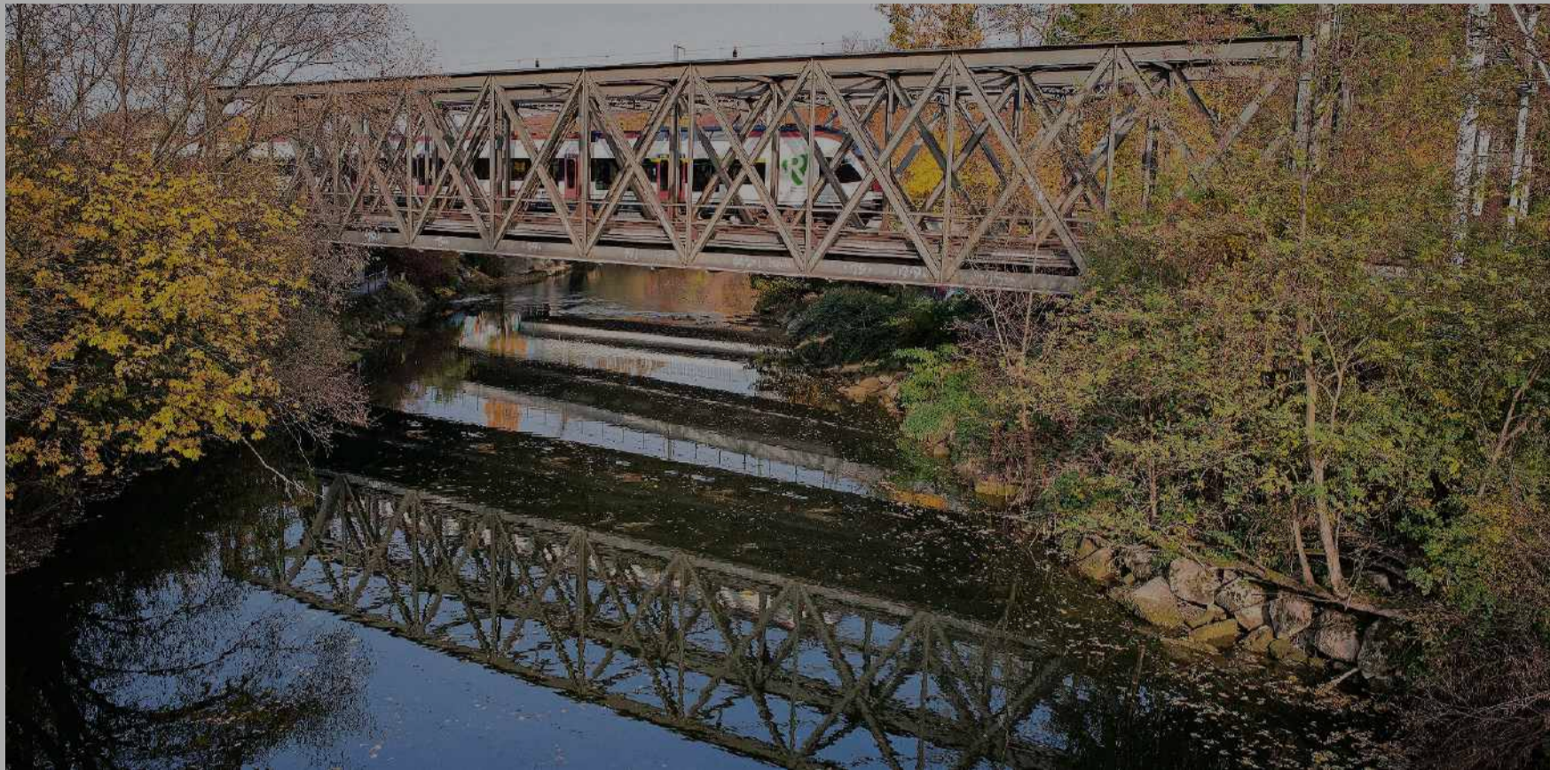
An der 1882 erbauten Eisenbahnbrücke in Münchenstein wurde eine Methode getestet, mit der man demnächst in Australien eine Brücke saniert.
